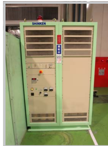
今回設置した省エネアンプ
